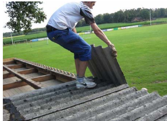
Abb. 3: Bei asbesthaltigen Baustoffen gilt äußerste Vorsicht
