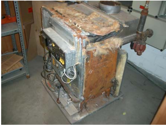
Abb. 2: Leider viel zu häufig: Marode Heizkessel
